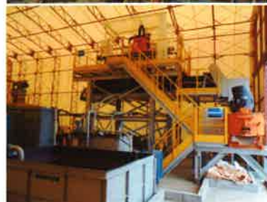
写真-1 浄化・減容化技術の実証試験プラント*
