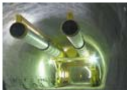
「換気システム」全景
